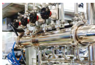
Flowmeter Medidor de caudal
